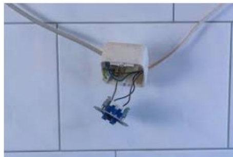
Instalacja elektryczna w starym domu ... dom.wp.pl
